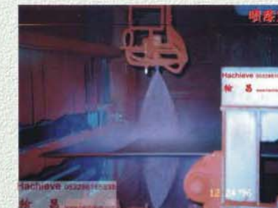
噴漆室 Spray chamber
